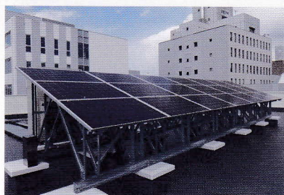
太陽光パネル
